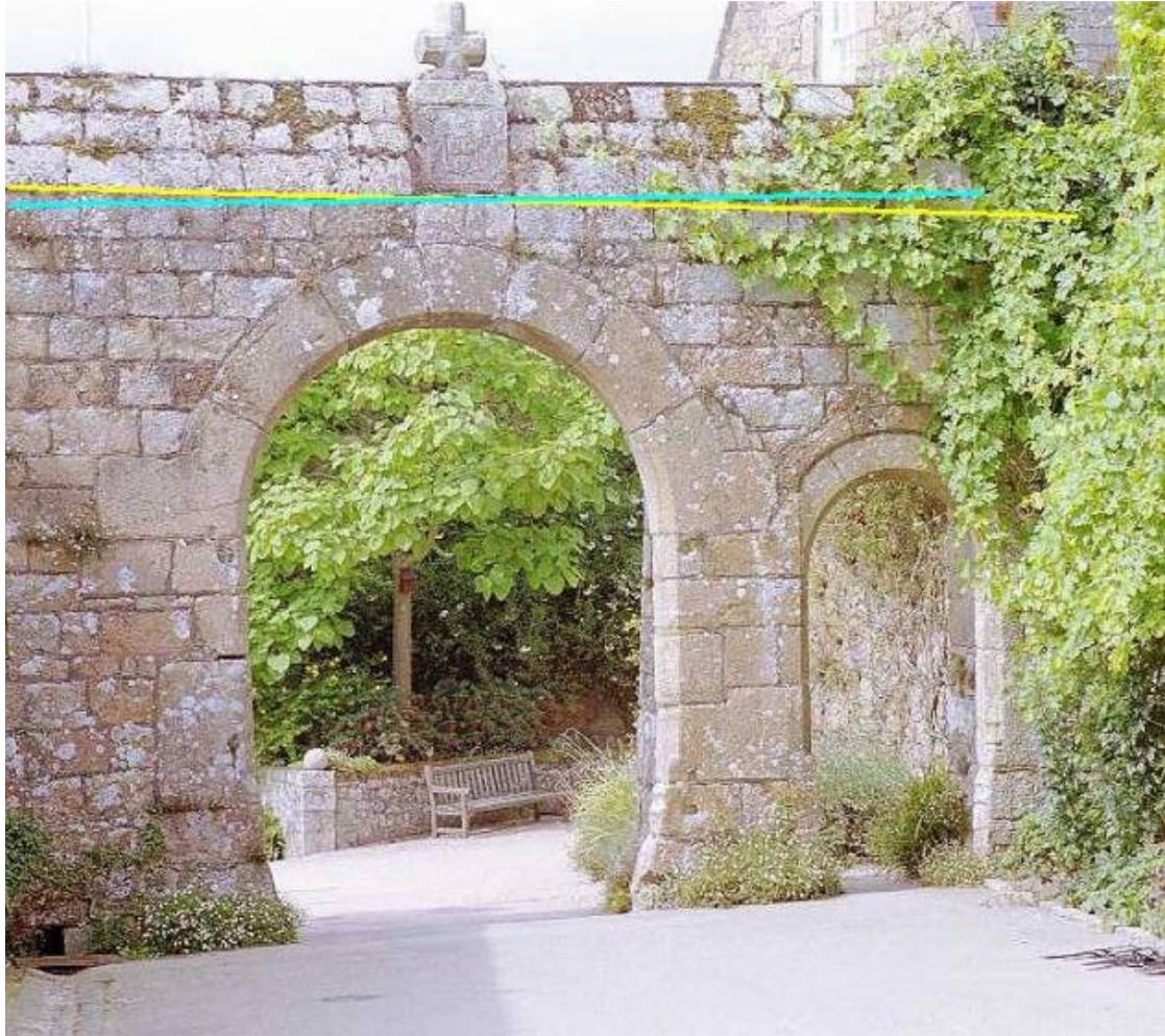
De boog is ietsjes ingezakt omdat de krachten naar beneden opgeheven moeten worden.
